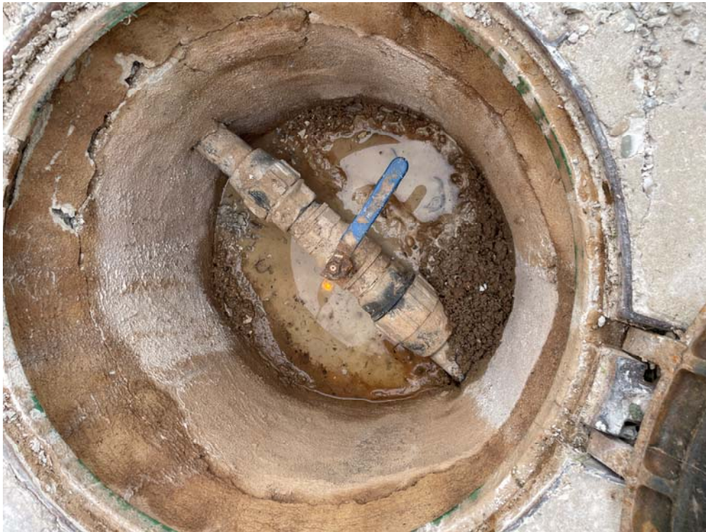
Fotografía nº1.- Nudo 1 con llave no operativa que fuga. Se va a instalar una nueva llave y un contador woltmann para control de la red.
