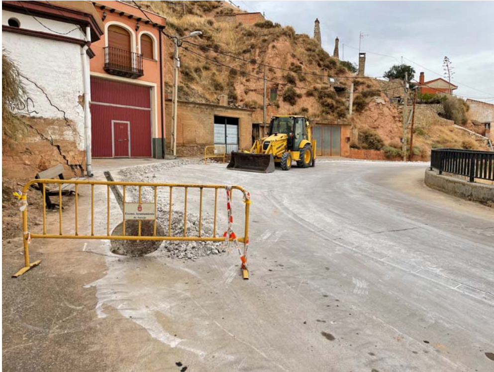
Fotografía nº3.- La obra de sustitución de tubería en la calle Turriente se va a realizar desde el pozo hacia abajo. Se observa la calle abierta en el tramo en el que se estaba cambiando la tubería por otra nueva PN16 el día que se fue a visitar el municipio.
