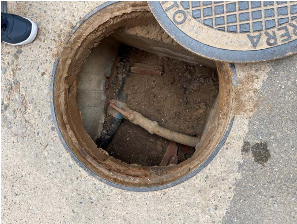
Fotografía nº5.- Nudo nº4. De la tubería DN 100 sale con un collarín una tubería DN50. Se va a cambiar la tubería DN50 por una DN90 y se van a inutilizar otras acometidas que salen de esta tubería para suministrar agua a la calle. Se va a sustituir la llave, que fuga por otra nueva y se va a añadir otra llave más para sectorizar.
