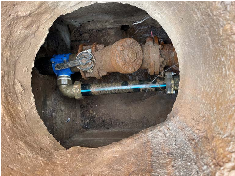
Fotografía nº4.- Nudo nº3. Se observa una válvula reductora de presión que no está operativa, así como su llave. Se ve que para solventarlo, se ha puesto un collarín con una tubería de menor sección haciendo un puente, para reducir la presión. Se va a sustituir por una nueva llave + válvula reductora de presión + contador de red.
